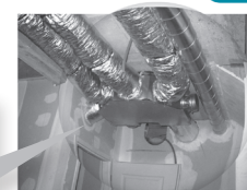
Figure 26.8 Module de chauffage complémentaire à l'échangeur. Chacun des départs, vers une chambre ou un séjour, comporte une batterie de chauffage. Chacune des batteries est réglée par asservissement à un thermostat présent dans chacune des pièces desservies (Doc. ALDES)
