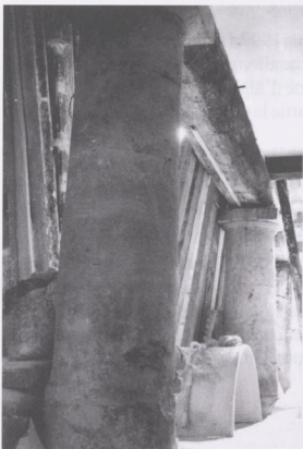
Moulin du Dos d'Asne : piliers du XVIII e siècle qui soutenaient la roue à aube.
