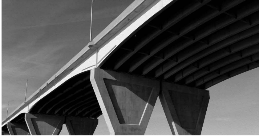
Figure 7 : ouvrage mixte pour lequel un grand nombre de poutres de faibles dimensions ont été mises en place, photo de Christophers Sessums
